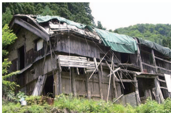
家屋破損状況（岩本豊家）平成16年頃
